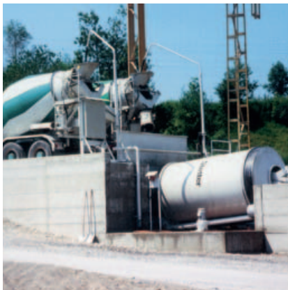
Ejecución encastrada con altura de alimentación a ras del suelo.
